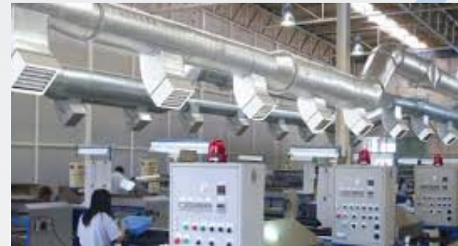
Hệ thống làm mát nhà xưởng
